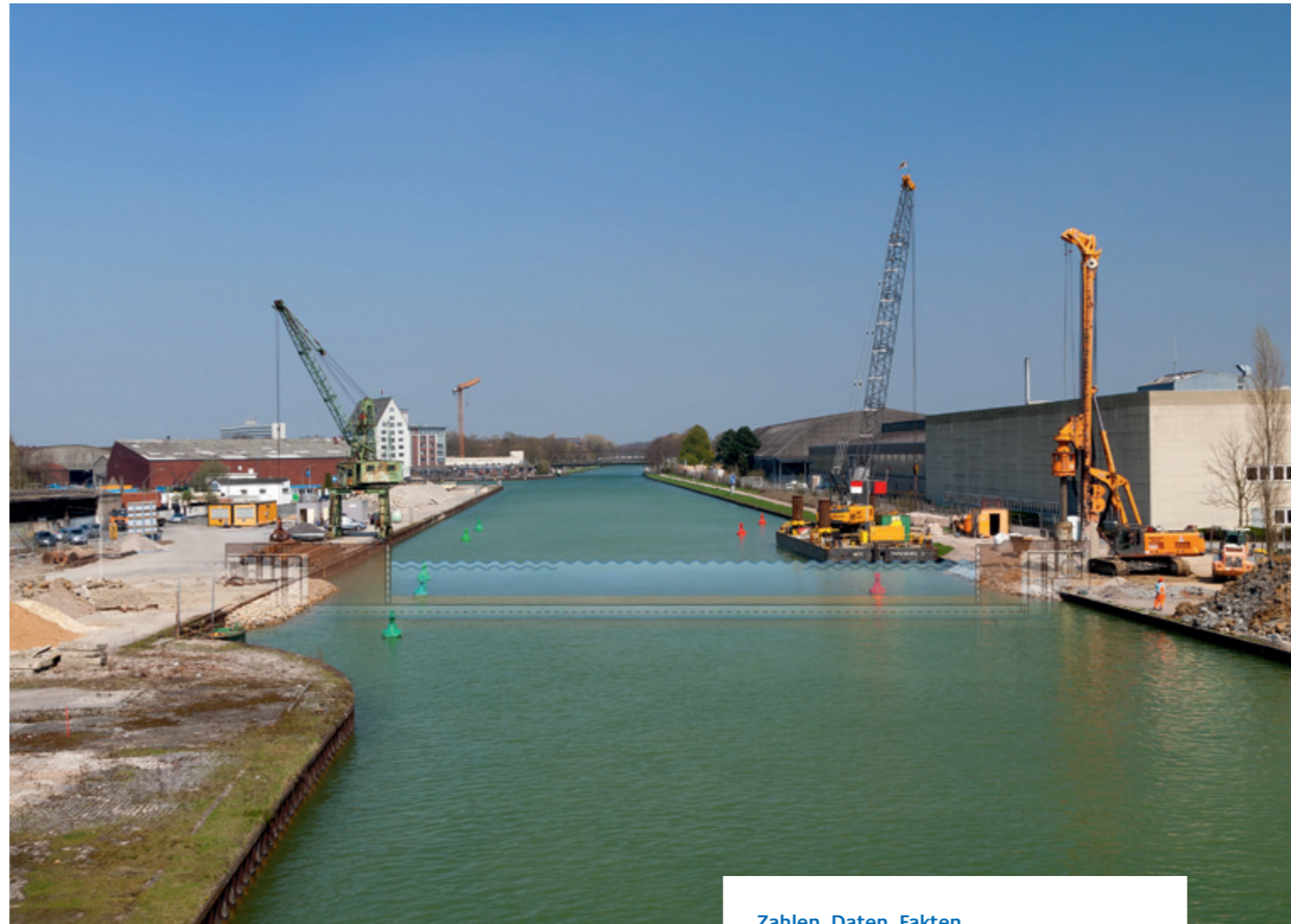
Der Petershafen-Düker führt in Münster die städtische Kanalisation und eine Gasleitung unter dem Dortmund-Ems-Kanal entlang.
